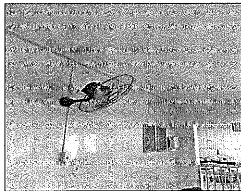
Ventiladores danificados e fiação exposta
