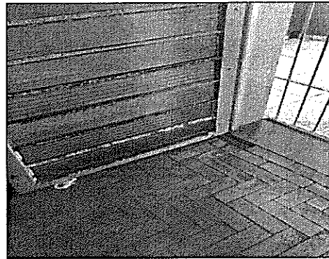
Portas e pisos danificados
