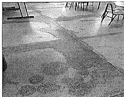
Infiltração no piso da sala
