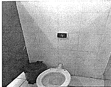
Banheiro quebrado e sem tampo
