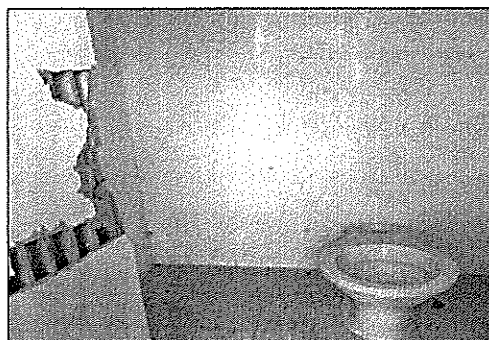
Vista do banheiro depredado
