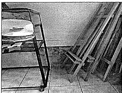
Infiltração na parede da sala
