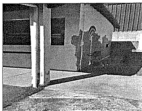
Parede danificada e infiltração no piso
