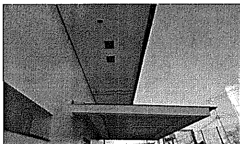
Rachadura no teto do corredor externo
