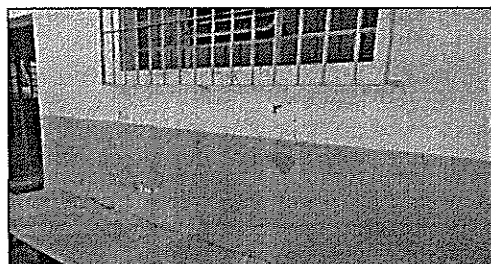
Desgaste na pintura na área externa
