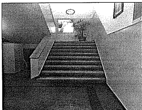
Nível superior sem acessibilidade
